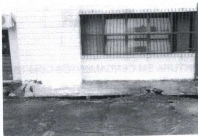
Pintura em vermelho nas esquadrias e grade da janela.
